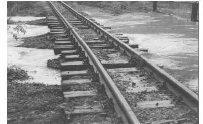
Die verbandseigene Döllnitzbahn ist beim Hochwasser noch mit einem blauen Auge davongekommen. Die Döllnitz, sonst etwa zwei Meter breit, schwoh auf bis zu 30 Meter an und trat über ihre Ufer. (Foto: Damunterspülung in Altmügeln). In den nächsten Tagen soll das Hilfsprogramm des Freistaates Sachsen und des Zweckverbands Nahverkehrsraum Leipzig für die Wiederherstellung sorgen. Ab Mitte September 2002 wird die Döllnitzbahn dann wieder fahren. (Foto: G. Franke, Mügeln)
