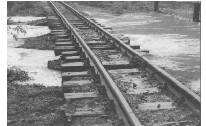
Die verbandseigene Döllnitzbahn ist beim Hochwasser noch mit einem blauen Auge davongekommen. Die Döllnitz, sonst etwa zwei Meter breit, schwoh auf bis zu 30 Meter an und trat über ihre Ufer. (Foto: Damunterspülung in Altmügeln). In den nächsten Tagen soll das Hilfsprogramm des Freistaates Sachsen und des Zweckverbands Nahverkehrsraum Leipzig für die Wiederherstellung sorgen. Ab Mitte September 2002 wird die Döllnitzbahn dann wieder fahren. (Foto: G. Franke, Mügeln)
