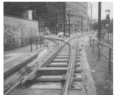
Wie am Alexanderplatz mussten auch am Hackeschen Markt die teilweise sehr engen Gleisraden erneuert werden. Sie waren ebenfalls im Winter gebaut worden. (Foto: Hans Grasse)
