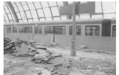
Am Lehrter Bahnhof fahren die S-Bahnen ohne Halt durch. Beim Bau wurde wegen künstlich erzeugtem Termindruck nur ein provisorischer Bahnsteigbelag aufgebracht. Dieser wird jetzt ganz langsam im Einschichtbetrieb und unter Heiligung des Wochenende ersetzt. (Foto: Florian Müller)
