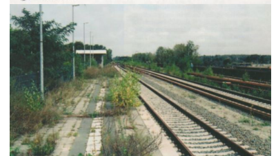
Der vor einigen Jahren neugebaute Bahnsteig des Regionalbahnhofs Teltow an der Anhalter Bahn wurde noch nie genutzt. Vor der Inbetriebnahme Mitte 2006 müssen erst einmal kleine Bäume gefällt und Vandalismusschäden beseitigt werden. (Foto: Christian Schultz)
