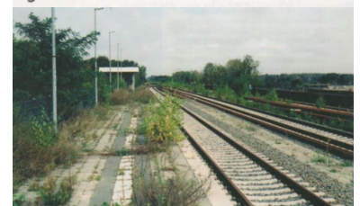
Der vor einigen Jahren neugebaute Bahnsteig des Regionalbahnhofs Teltow an der Anhalter Bahn wurde noch nie genutzt. Vor der Inbetriebnahme Mitte 2006 müssen erst einmal kleine Bäume gefällt und Vandalismusschäden beseitigt werden. (Foto: Christian Schultz)
