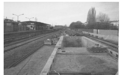
Bahnhof Charlottenburg, Blick nach Westen. Das Foto vom Dezember 2004 zeigt den neuen Bahnsteig D mit dem Rohbau des Treppenabgangs zur Lewishamstraße und Strecken- und Betriebsgleisen (Gleiswechsel und zweigleisige Kehranlage). (Foto: Florian Müller)
