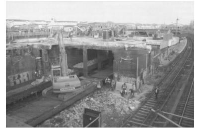
In nur wenigen Wochen wurde das baufällige Empfangsgebäude des S-Bahnhofs Warschauer Straße Anfang 2005 beseitigt. Könnte es sein, daß die DB froh war, somit einer Diskussion über die durchaus erhaltenswürdige Architektur des nun ehemaligen Bahnhofsgebäudes entkommen zu sein? (Foto: Marc Heller)
