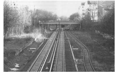
Unter der Brücke soll Anfang 2007 der S-Bahnhof Kolonnenstraße in Betrieb gehen - wenn nichts dazwischen kommt. Die beiden S-Bahngleise bekommen Außenbahnsteige. Das Logistik-Gütergleis rechts wird verschoben und kann später für die Stammbahn nach Düppel genutzt werden. Links die alte Bahnsteigkante des Ringbahnhofs. Blick Richtung Süden auf die Julius-Leber-Brücke. (Foto: Florian Müller)
