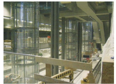
Von zwei der vier Tunnelbahnsteige geht es per Aufzug umsteigefrei zu den Stadtbahnsteigen (Foto: Florian Müller, November)
