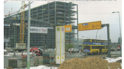
Haltestelle auf der Invalidenstraße für sieben Buslinien am Hauptbahnhof-Lehrter Bahnhof. Auf die Straßenbahn vom Nordbahnhof werden die Fahrgäste aber noch viele Jahre warten müssen. (Foto: Florian Müller)
