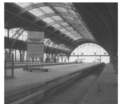
Leipzig Hauptbahnhof ohne Gleise. Für die Bauarbeiten wurden die Gleise 7 bis 7 entfernt. Hierunter entsteht die neue Tunnelstation. (Foto: Florian Müller)
