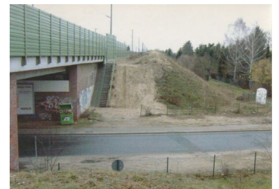
Spandau, Hackbuschstraße. Der Bahndamm für die Verbreiterung um ein oder zwei weitere Gleise ist bereits größtenteils fertig. Die Brückenbauwerke können einfach ergänzt werden. (Foto: Florian Müller)
