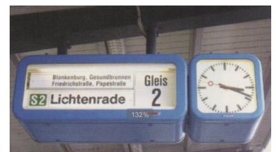
Beliebt. Diese Fallblattzugzielanzeiger sind bei der Berliner S-Bahn sehr verbreitet. Weil sie nicht mit dem neuen »Reisenden-Informationssystem" der DB kompatibel sind, werden sie abgebaut. (Foto: Florian Müller)
