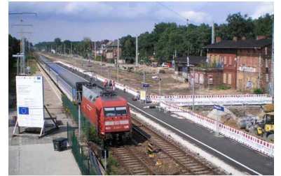
Mangelhaft. Der Ausbau der Strecke Berlin--Dresden beschränkt sich derzeit auf punktuelle Einzelmaßnahmen wie den Umbau des Bahnhofs Rangsdorf. Bei der Errichtung des provisorischen Bahnsteigs (Richtung Berlin) wurde ein Wetterschutz »vergessen«, und Sitzbänke sind Mangelware - Kundenfreundlichkeit sieht anders aus! (Foto: Christian Schultz)
