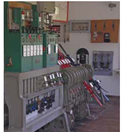
Die mechanische Stellwerkstechnik arbeitet seit Jahrzehnten zuverlässig und sicher, hier im Bf. Bischofswiesen; der Betrieb ist jedoch personalintensiv. (Foto: Christian Schultz)
