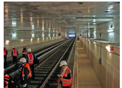
Die U 6 durchfährt seit dem 17. November 2013 den Rohbau-Bahnhof Unter den Linden. Die Bahnsteigplatten fehlen noch, ebenso die Anlagen der neuen U 5 unterhalb dieses U6-Bahnhofes. (Foto: Florian Müller, 29. Oktober 2013)
