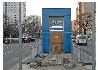
Schildbürgerstreich. Am U-Bf Magdalenenstraße ist seit Februar 2013 der Aufzug fertig. Aber weil die Verkehrslenkung Berlin die erforderliche Anpel zunächst nicht genehmigte, ist der Aufzug noch immer nicht in Betrieb. (Foto: Marc Heller)
