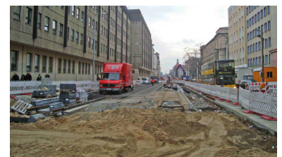
Die Kreuzung Chausseestr./Invalidenstr. ist noch immer eine große Baustelle, vor allem für die Erneuerung der Versorgungsleitungen. (Foto: Florian Müller)
