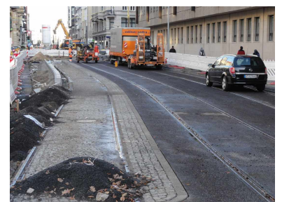
Die Haltestelle Naturkundemuseum erhält drei Gleise. Links eingepflastert liegt das Gleis zum Hauptbahnhof. In der Mitte (Geradausspur) das Gleis zum Rechtsabbiegen in die Chausseestraße, rechts am Bordstein das Gleis geradeaus zum Nordbahnhof. (Foto: Holger Mertens)
