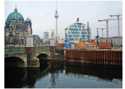
Hier unter dem Wasser des Kupfergrabens soll der neue U-Bahnhof Museumsinsel entstehen. Der Schildvortrieb steht derzeit wegen zu hohem Wassereintritts in die Bahnhofsbaustelle still, bevor er das Flussbett unterquert. Links die Schloßbrücke und der Berliner Dom, in der Mitte der Fernsehturm und die temporäre Humboldt-Box, rechts der Rohbau des neuen Berliner Stadtschlösses/Humboldtforums. (Foto: Florian Müller, Mitte Januar 2014)
