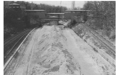
Der S-Bahnhof Eichkamp im Mai 1992 und im Februar 1994. Anstatt den Bahnsteig instandzusetzen, wurde er vollständig abgetragen. (Foto: Eckart Kuntzsch)
