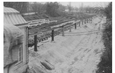
Der S-Bahnhof Heerstraße im Dezember 1993 und im März 1994. Der alte Bahnsteig mit den denkmalwerten Aufbauten wurde abgebrochen. Erhalten blieben lediglich die Stützen und Träger des Bahnsteigdaches. Das Dach hätte jedoch vollständig erhalten bleiben können, da sich die für die stillgelegten Strecken zuständige VdeR kontinuierlich um die Instandhaltung gekümmert hatte. Mit der brutalen Abrißaktion hat die Senatsbauverwaltung also nicht nur wertvolle historische Bausubstanz vernichtet, sondern Millionenbeträge verschwendet. (Foto: Eckart Kuntzsch)
