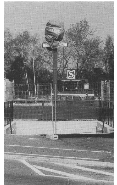
Pendelverkehre, geschlossene Bahnhofseingänge. Seit Jahren leiden die Fahrgäste unter den scheinbar unendlichen Bauarbeiten am Nord-Süd-Tunnel der S-Bahn. (Foto: Frank Lammers)
