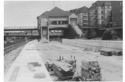
Sommer 1990. Vom alten S-Bahnsteig in Witzleben ist nichts mehr vorhanden. Vier Jahre lang wurde der Südring umfassend erneuert. Doch vier Monate nach der Wiederinbetriebnahme müssen sich die Fahrgäste auch auf dem Südring schon wieder mit Fahrplanänderungen durch Bauarbeiten herummärgern. (Foto: Heinz-Peter Schwarz)
