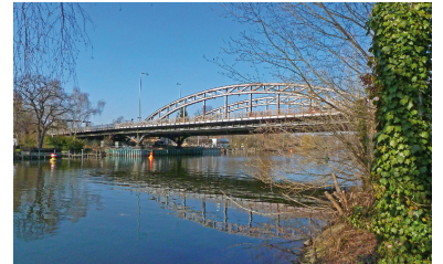
Die Freybrücke ist nicht mehr tragfähig, deshalb darf sie nur noch von Fahrzeugen bis 18 Tonnen befahren werden - das gilt auch für Busse. Die plötzliche Einschränkung führte zu einem Verkehrschaos für die Busfahrgäste. (Foto: Raul Stoll)
