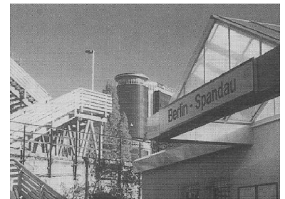
Wegen der Bauarbeiten können die Reisenden von Berlin-Spandau (oder Zoo, Lichtenberg, Schönefeld) den IC nach Hamburg seitdem 24. September 1995 zuschlagfrei nutzen. Von Reisenden zwischen Berlin und Nauen verlangte die Bahn demgegenüber den IC-Zuschlag. Erst im März wurde diese Schikane ausgeräumt. (Foto: Stefan Schnerr)
