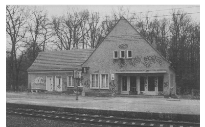
Völlig verfallend sind die Bahnhöfe Schönwalde (Kr Nauen) und Falkenhagen (Kr Nauen) auf dem Berliner Außenring. Mit dem Fahrplanwechsel am 2. Juni wird hier kein Zug mehr halten. Zwar liegen die Bahnhöfe abseits der Siedlungen, aber für Ausflüger aus dem nahen Berlin sind sie als Ausgangspunkt von Fuß- oder Radwanderungen gut geeignet. (Foto: Marc Heller)
