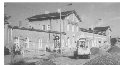
Noch lange nicht fit für den Verkehrsverbund. Zwar gestaltet die Stadt Angermünde zur Zeit ihren Bahnhofsvorplatz inklusive Busbahnhof um, das Bahnhofsgebäude selbst steht allerdings wie ein fauler Zahn am Platz. Die Akzeptanz des Verbundes durch die Bürger hängt jedoch unter anderem von einer attraktiven baulichen Gestaltung der Schnittstellen zwischen Bahn und Bus ab. (Foto: Stephan Müller)
