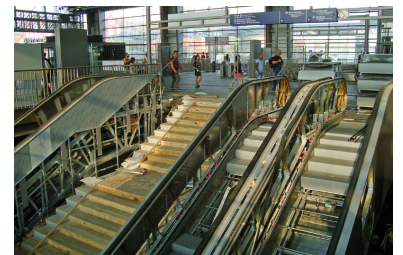
Zwischen den S-Bahnsteigen F und D werden nur 3 anstatt 4 Fahrtreppen eingebaut. Das ist für die zu erwartenden Fahrgastströme nicht ausreichend. (Foto: Florian Müller)
