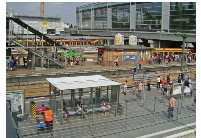
Ostkreuz, Bauzustand Stadtbahnebene Ende Juli 2014. Im Vordergrund der Regio-Bahnsteig Ru, an dem ab Ende 2017 die Regionalzüge von der Stadtbahn (RE 1, RE 2, RE 7, RB 14) halten sollen. Seit 30. Juni 2014 wird dieser Bahnsteig provisorisch für drei Jahre von der S 3 genutzt. Dahinter der alte S-Bahnsteig E mit dem letzten charakteristischen Bahnsteighäuschen. Dieser Bahnsteig wird im Herbst 2014 abgerissen. Wiederum dahinter entsteht der neue S-Bahnsteig D mit einem Dach. Rechts befindet sich die 2012 fertiggestellte neue Ringbahnhalle mit dem S-Bahnsteig F. (Foto: Florian Müller)
