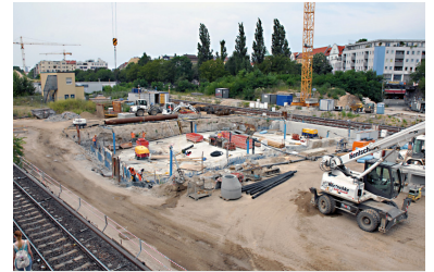
Baugrube für eine weitere Verlängerung der Autobahn A100. Hier werden Vorleistungen für einen doppelstöckigen Autobahntunnel unter dem Ostkreuz gebaut. Die Arbeiten beeinträchtigen und verzögern den Umbau der Bahnanlagen erheblich. (Foto: Marc Heller)
