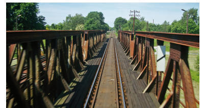
Die Neißebücke bei Forst, fotografiert aus dem Wawel. Das zweite Gleis links ist seit langem außer Betrieb. Der rostige Zustand der Brücke steht symbolisch für die Eisenbahnverkehre Deutschland--Polen. (Foto: Florian Müller)
