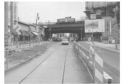
Neue Straßenbahngleise in der Friedrichstraße (Blick im Oktober 1996 von der Weidendammer Brücke Richtung Süden). Doch die Inbetriebnahme ist erst für Ende 1997 vorgesehen - Berliner Schnecken-tempo wie eh und je. (Foto: Marc Heller)
