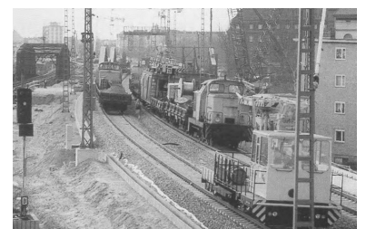
Alte und neue Streckengleise zwischen dem alten und dem neuen Bahnhof Berlin-Spandau. Aber trotz intensiver Arbeiten ist der 4. Mai als Inbetriebnahmetag nach letzten Meldungen nicht mehr zu schaffen. (Foto: Marc Heller)
