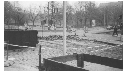
Beispiel für unkoordinierte Bauabläufe: Die erst vor zwei Jahren erneuerten Gleise an der Brunnen-/Invalidenstraße werden zur Zeit gerade wieder herausgerissen. Der Straßenbahnverkehr ist erneut unterbrochen, dieses Mal für mindestens drei Monate. (Foto: Norbert Stegemann)
