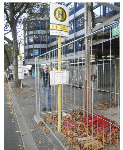
Immer wieder machen unbenutzbare Haltestellen den Fahrgästen Ärger. Wenn eine Haltestelle (wie hier »An der Urania«) so zugestellt ist, muss die BVG eine Verschiebung oder eine Ersatzhaltestelle organisieren. Die Hinnahme solcher Zustände durch die BVG ist Vereitelung der Fahrgast-Information von Amts wegen. Hier müssen die BVGLinien-bzw. Gebiets-Manager einschreiten. (Foto: Thomas Brodthage)
