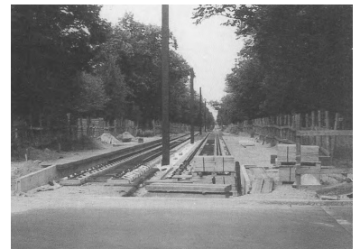
Straßenbahn-Haltestelle Virchow-Klinikum drei Monate vor der Streckeneröffnung. So schnell kann Straßenbahnbau gehen - wenn man nur will (Foto: Marc Heller)
