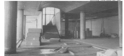
Schmale Treppen zu den Bahnsteigen im neuen Bahnhof Spandau. (Foto: Florian Müller)
