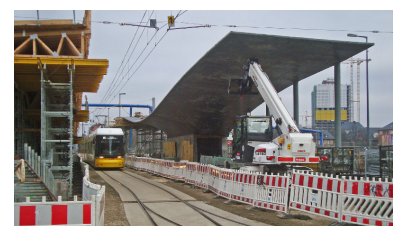
Das filigrane Beton-Haltestellendach wurde nicht rechtzeitig fertig. Die Straßenbahn fährt provisorisch eingeleisig durch die Baustelle zur Ersatzhaltestelle. Während mehrerer abendlicher Betriebseinstellungen wurde das Schalgerüst abgebaut. (Foto: Florian Müller, 23.1.2015)
