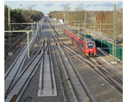
Bahnhof Rangsdorf . Bereits seit 2001 wird an der Ausbaustrecke Berlin--Dresden gearbeitet. Diese Dauerbaustelle sorgt so für anhaltende Wettbewerbsnachteile für den Verkehrsträger Schiene. (Foto: Christian Schultz)
