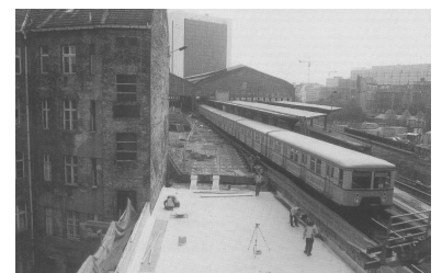
Stadtbahn-Sanierung 1995: Bau der »Festen Fahrbahn« für die S-Bahn am Bahnhof Friedrichstraße (Foto: Dirk Riediger)
