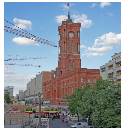
Noch wird die Rathausstraße durch die U5-Baustelle dominiert. Die Straßenbahn zum Potsdamer Platz ist seit 1990 fest vorgesehen. Dennoch wurde sie beim Neubau der Rathausbrücke aus Kostengründen nicht berücksichtigt. Das wird sich später rächen, denn für die Zukunft werden beide Strecken gebraucht: eine durch die Leipziger und eine durch die Französische Straße. (Foto: Tom Gerlich)
