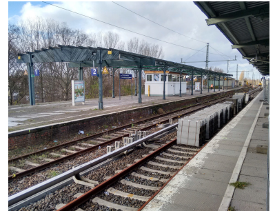
Regionalbahnsteig in Berlin-Schöneweide. Noch fährt die RB 24 ohne Halt durch, aber ab 21. März sollen die Züge hier halten können. (Foto: Holger Mertens)
