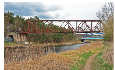
Die stillgelegte S-Bahn-Brücke nach Stahnsdorf will die DB noch 2016 abreißen. Das Land Brandenburg untersucht, ob eine Wiederinbetriebnahme sinnvoll ist. (Foto: Florian Müller)
