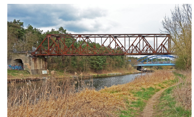
Die stillgelegte S-Bahn-Brücke nach Stahnsdorf will die DB noch 2016 abreißen. Das Land Brandenburg untersucht, ob eine Wiederinbetriebnahme sinnvoll ist. (Foto: Florian Müller)
