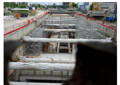
Blick durch ein Astloch im Bretterzaun auf den S21-Tunnel nördlich der Invalidenstraße. Hier ist die Tunneldecke bereits hergestellt. In diesem Bereich soll der provisorische kurze Tunnel-Bahnsteig entstehen. (Foto: Florian Müller, Juli 2016)
