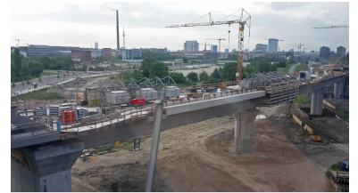
Hier auf dem Viadukt sollte der neue S-Bf Perleberger Brücke mit Seitenbahnsteigen ergänzt werden. Links schließt die Bogenbrücke über die Perleberger Brücke an, rechts am Horizont ist der Hbf zu erkennen. (Foto: Florian Müller)
