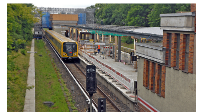
Baustelle (oben) und geplanter Endzustand (unten). Der U-Bahnhof »Neue Grottkauer Straße« auf der U 5 wird schick gemacht für die Internationale Gartenausstellung IGA 2017. Außerdem erhält er einen neuen Namen: »Kienberg - Gärten der Welt«. Nebenbei: Auf die gleichzeitige Umbenennung der U3-Station »Thielplatz« in »Freie Universität« verzichtet der Berliner Senat leider. (Visualisierung: BVG)
