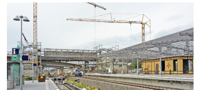
Noch gebietet der Prellbock für die S 3 Halt am Ostkreuz. Dahinter sind die beiden neuen geschwungenen Brücken der Südringkurve zu sehen, davor die wiederaufgebaute Fußgängerbrücke. Rechts ist der erneuerte Bahnsteig D mit den Dachstützen und der Aufsichtsbude im historischen Stil zu sehen. (Foto: Florian Müller)
