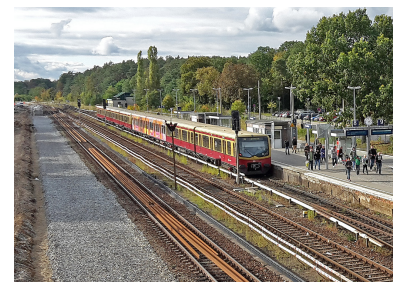
Die vorbereitenden Arbeiten für den Umbau des Bahnhofs Strausberg haben begonnen. Dabei sollen die Gleise von S- und Regionalbahn, die bisher gemeinschaftlich genutzt werden, getrennt werden. Links neben dem S-Bahn-Gleis soll ein neuer Regionalbahnsteig entstehen. So könnten die S-Bahn-Fahrgäste nach beiden Seiten aus dem Zug aussteigen - zum Ausgang oder zum Umstieg zum Regionalverkehr. Diese kundenfreundliche Lösung birgt allerdings technische und zulassungsrechtliche Probleme, die hoffentlich noch gelöst werden können. (Foto: Florian Müller, Mitte Oktober 2016)
