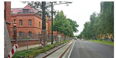
Neben der B2 ist die neue Strecke auf 300 Meter Länge zwar nur eingleisig, aber stauunabhängig. Links im Bild die »Roten Kasernen«, die seit einigen Jahren Wohnzwecken dienen. (Foto: Florian Müller)
