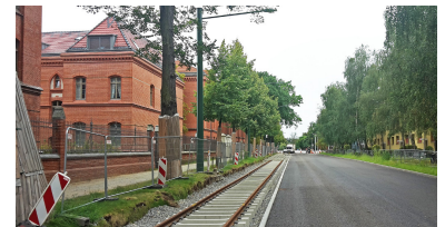
Neben der B2 ist die neue Strecke auf 300 Meter Länge zwar nur eingleisig, aber stauunabhängig. Links im Bild die »Roten Kasernen«, die seit einigen Jahren Wohnzwecken dienen. (Foto: Florian Müller)
