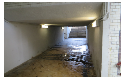
...und, schlimmer noch, der Personentunnel zeigen. (Foto: Christian Schultz)
