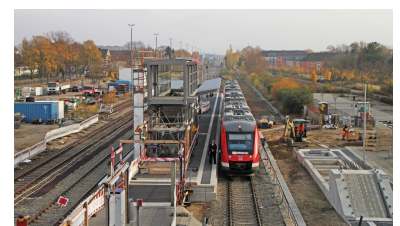
Der Bahnhof Velten wird zurzeit umfangreich umgebaut - aber noch ohne S-Bahn. Links ist die Fläche für einen späteren S-Bahnsteig freigehalten. (Foto: BfVst)
